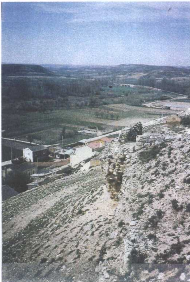
Foto 6: Fábrica del Castillo altamente degradada e inestable.
