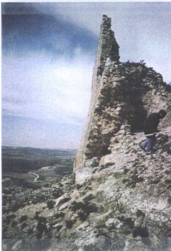
Foto 12: La precaria estabilidad de las ruinas, un factor de inestabilidad.
