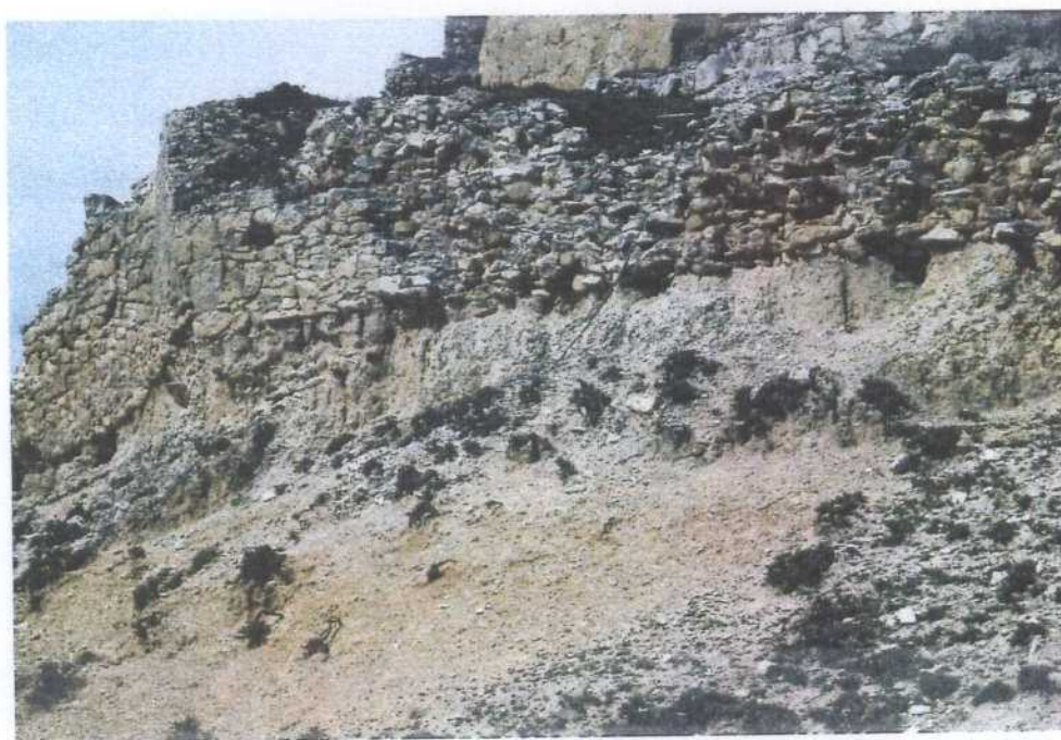
FOTO 4 Degradación de la fábrica del Castillo y causa de los desprendimientos.
