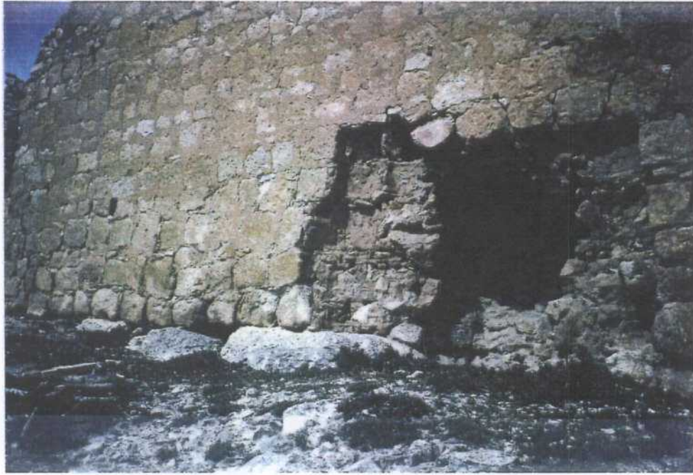
FOTO 5 Degradación de la fábrica del Castillo
